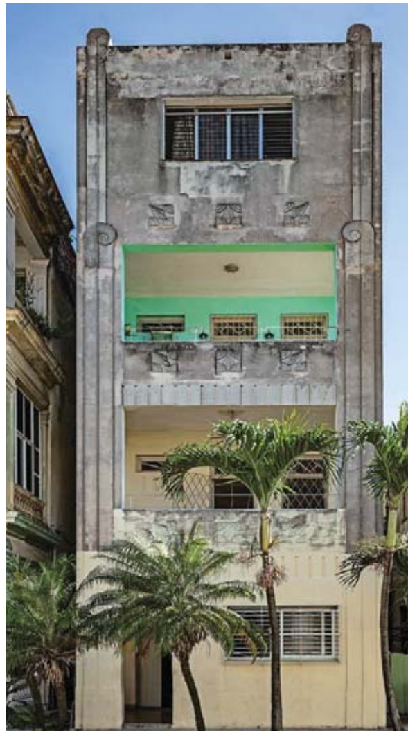
Fig. 96. Casa di calle Luaces , L'Avana, Luaces n. 7, tra Lugareño e Carlos III. Foto A. Cannatello.
