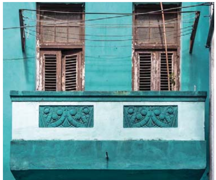
Fig. 92. Edificio Maura Aurea , L'Avana, Sitios nn. da 804 a 820, angolo con Plasencia nn. 116 e 118, particolare con balcone del n. 814. Foto A. Cannatello.
